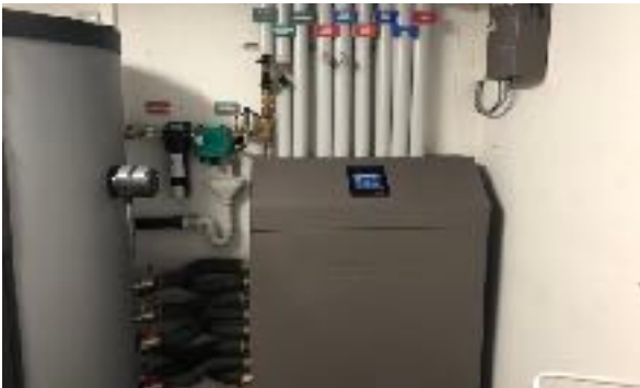
Pufferspeicher mit Heizschwert und Heizzentrale
